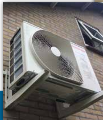
hybride warmtepomp aan de gevel
